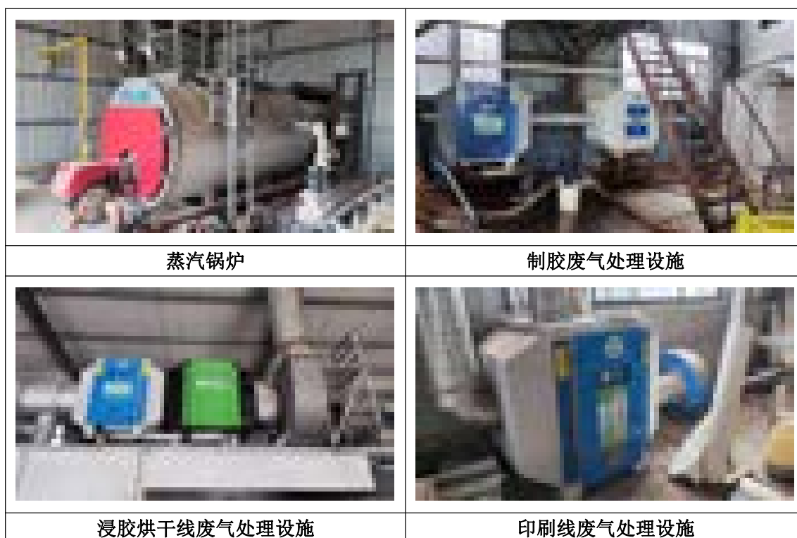
图 4.1-1 项目（一期）废气处理设施
