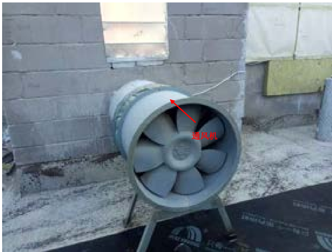
图 4-1 运营期废气治理设施照片
