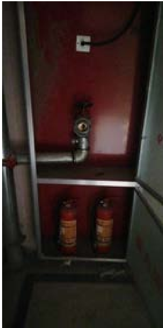
图4-2 消火栓、灭火器照片
