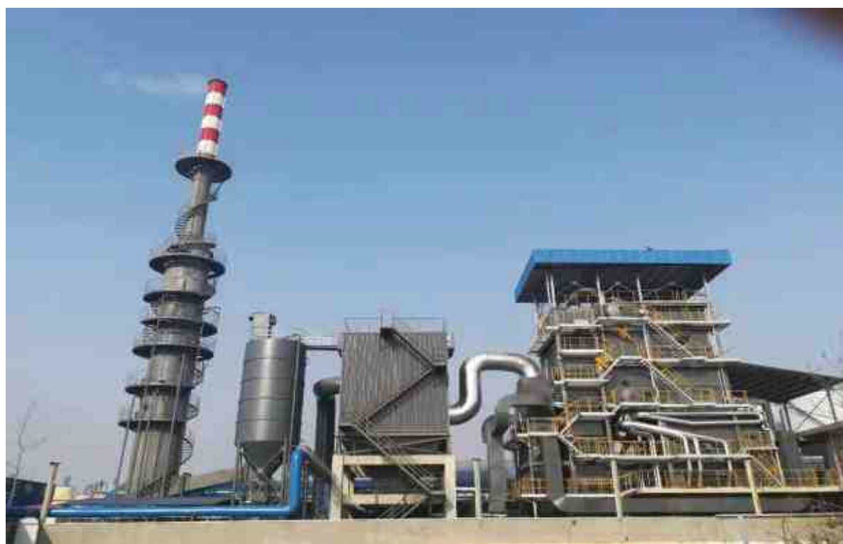
低氮燃烧+SNCR+SCR 脱硝+石灰石-石膏湿法脱硫+布袋除尘系统+45 米高排气筒及配套水煤浆输送管道，粉尘煤灰输送管道（总览图）
