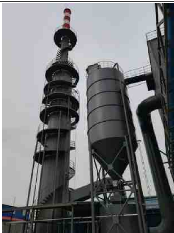
脱硫脱硝装置
